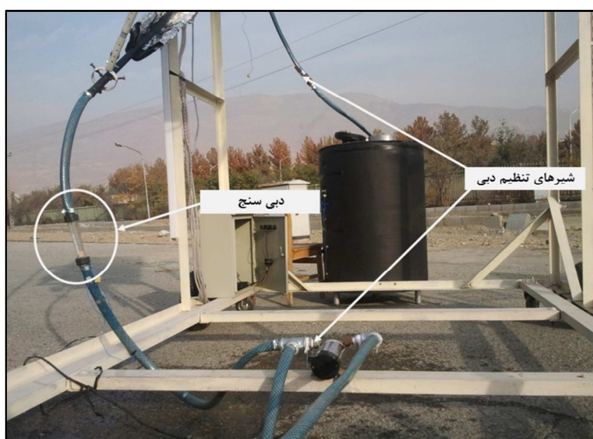
شکل ۴- شیرهای تنظیم دبی در سامانه گرمایش خورشیدی
